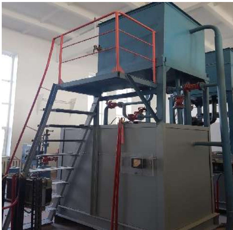
Рисунок 9.1 – Установка с погружными скважинными насосами
