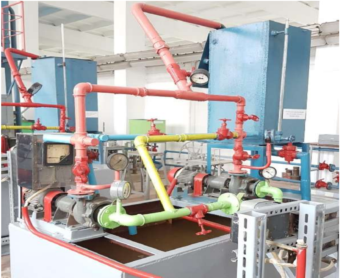
Рисунок 5.1 – Установка с одинаковыми центробежными насосами
