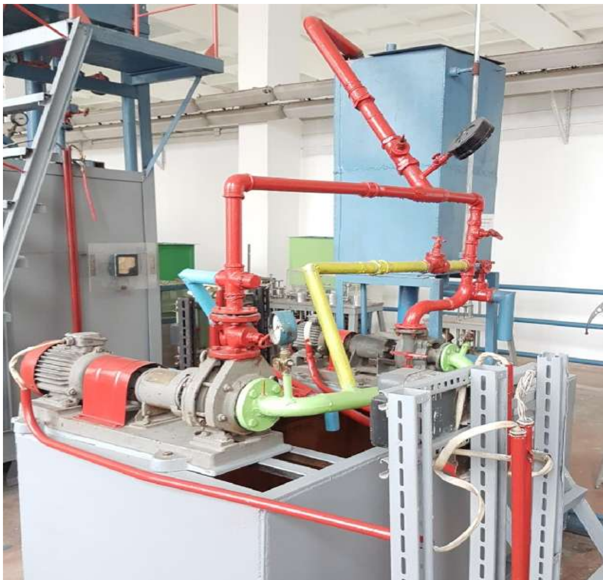
Рисунок 7.1 – Установка с разными центробежными насосами
