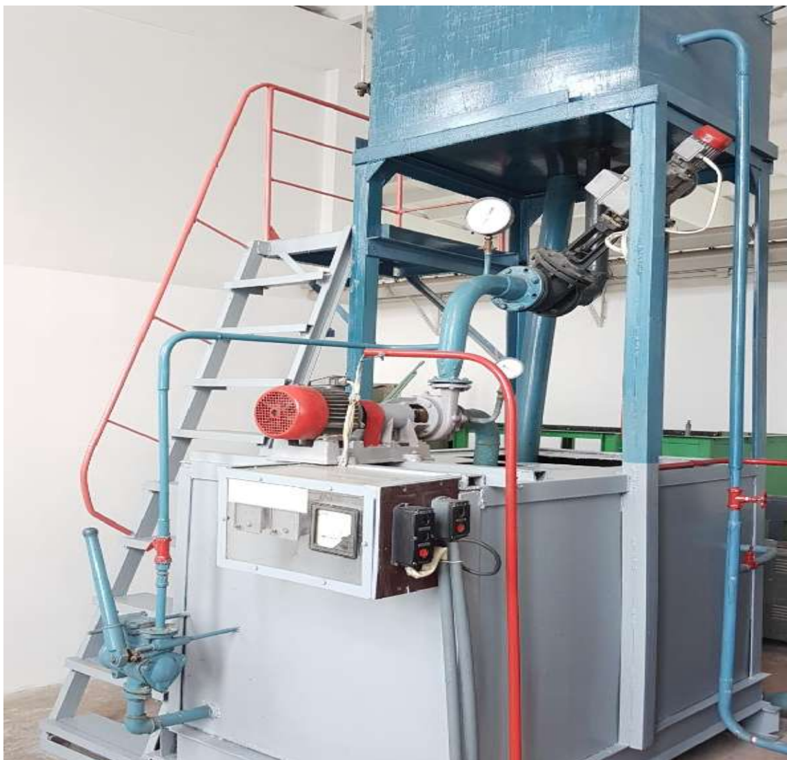
Рисунок 3.1 – Установка для исследования условий всасывания центробежного насоса К 20/30 У2
